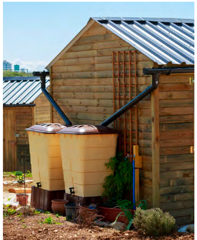
Sistem de colectare a apei pluviale de pe acoperișul clădirii (fotografie din internet)
